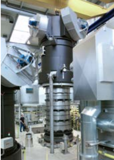
Kundenspezifische Adaptierung von Standardventilatoren im Industrieofenbau.
